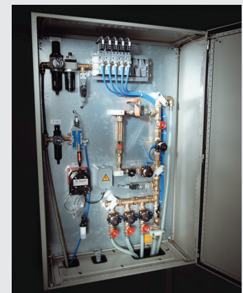
Pneumatik-, Prozesswasser- und Compoundverteilung
